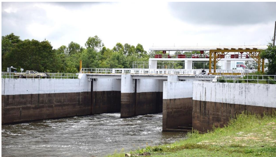
ภาพที่ 16 ประตูระบายน้ำบ้านนาคู
